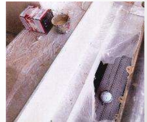
落下箇所状況写真
